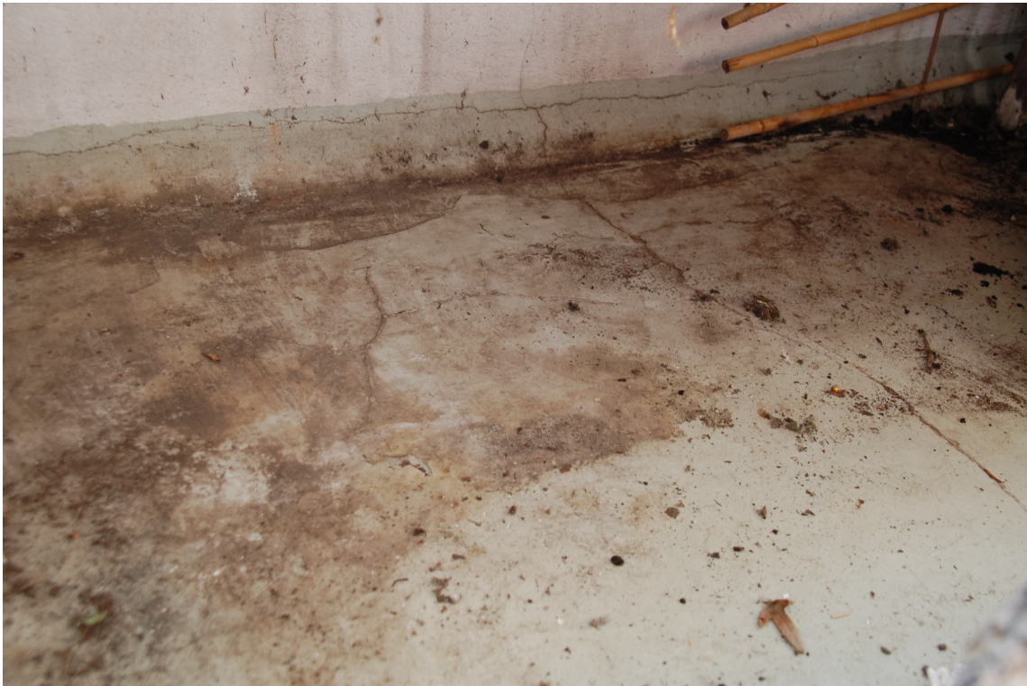
Bild 13 WE Müller – Heinrich; netzförmige Risse im Bodenbereich; Risse im Bereich der Aufstandsfuge
