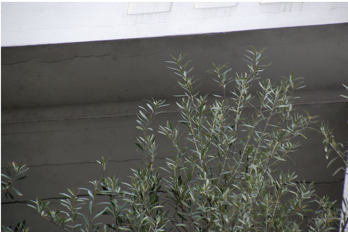
Bild 4 Rissbildungen im Außenbereich des Balkons der WE Schöler
