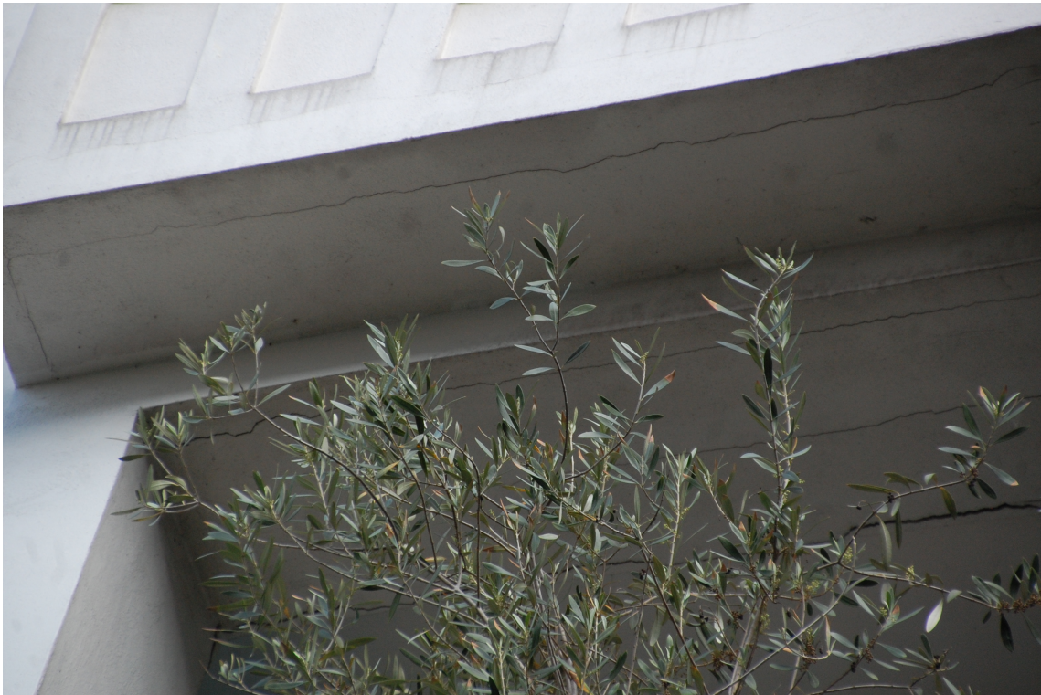
Bild 3 Rissbildungen im Außenbereich des Balkons der WE Schöler
