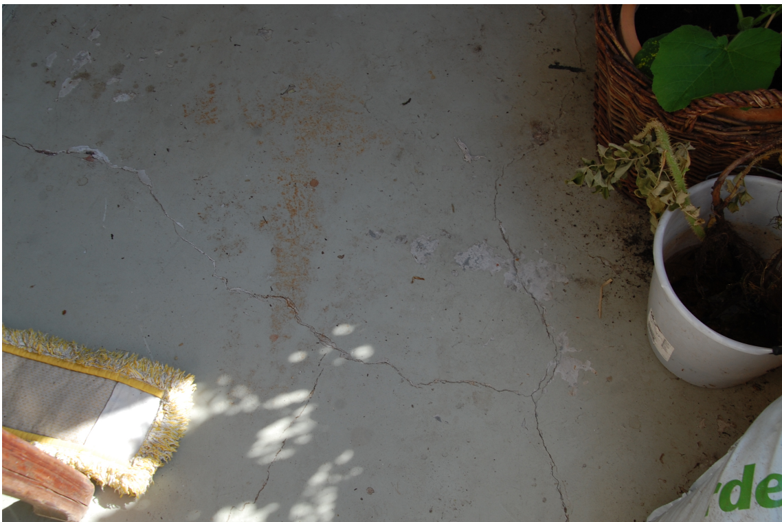
Bild 12 WE Müller – Heinrich; netzförmige Risse im Bodenbereich
