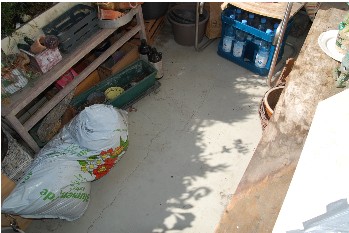
Bild 10 WE Müller – Heinrich; netzförmige Risse im Bodenbereich
