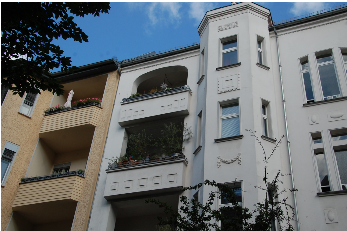
Bild 2 Der schadhafte Balkon befindet sich über dem 2. und 3. OG; keine Notüberläufe vorhanden
