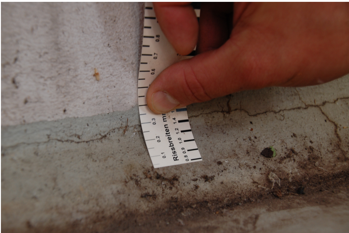
Bild 14 WE Müller – Heinrich; Rissbreite 0,3 mm im Bereich der Aufstandsfuge
